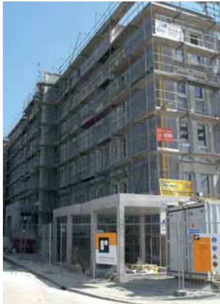
29 Wohnungen in diesem Neubau der Flüwo Bauen Wohnen eG werden über Erdwärmennutzung beheizt
